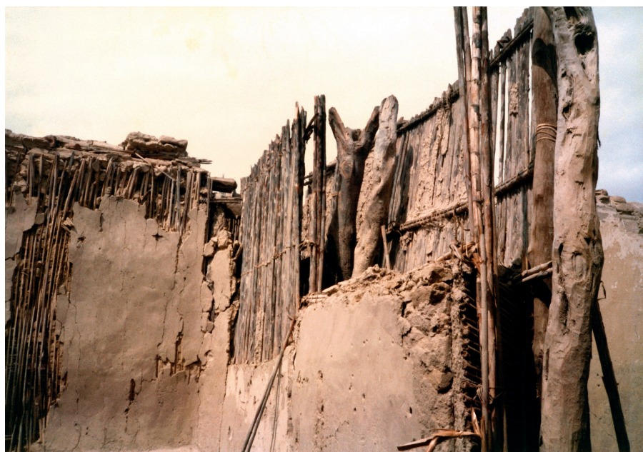
Figura 11. Pared divisoria, Santa Cruz de Lancha, mostrando la arquitectura de quincha (foto: Ana María Soldi).
