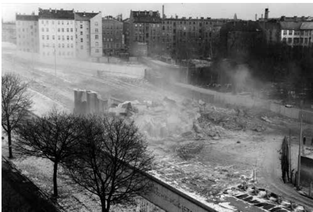
Figuras 1, 2 y 3: secuencia de la destrucción en 1985 de la Capilla de la Reconciliación primigenia en Bernauer Strasse, Berlín. Fotos del Archivo Evangelische Versöhnungsgemeinde, Berlín.
