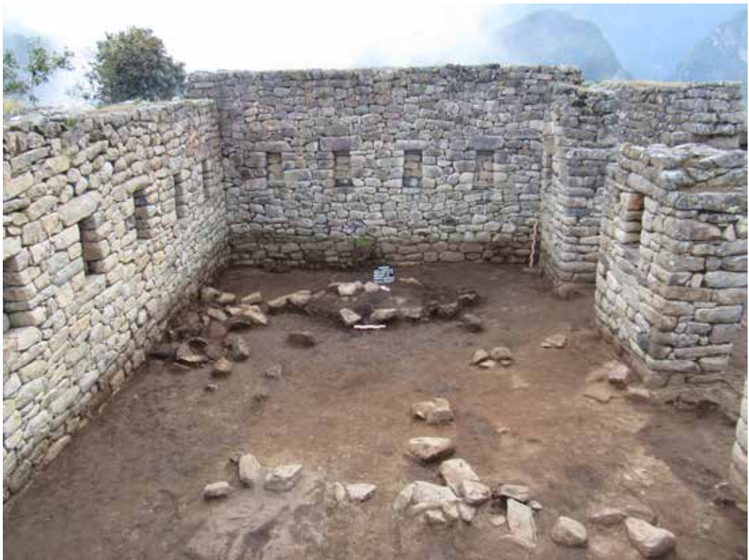
Figura 11. Vista general de la UE12-2017. Nótese la presencia de elementos líticos dispersos producto del colapso de la parte superior de los muros (fotografía: José Luis Sinchiroca).
