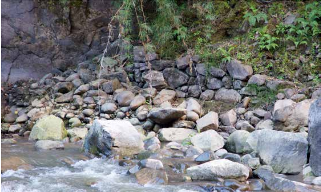
Figura 28. Estribo en la margen izquierda del río Vilcanota correspondiente al puente Andenes Orientales (fotografía: Alicia Fernández).
